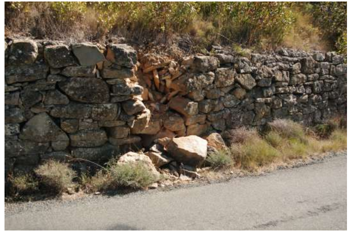
> Muret de pierre sèche en partie effondré
