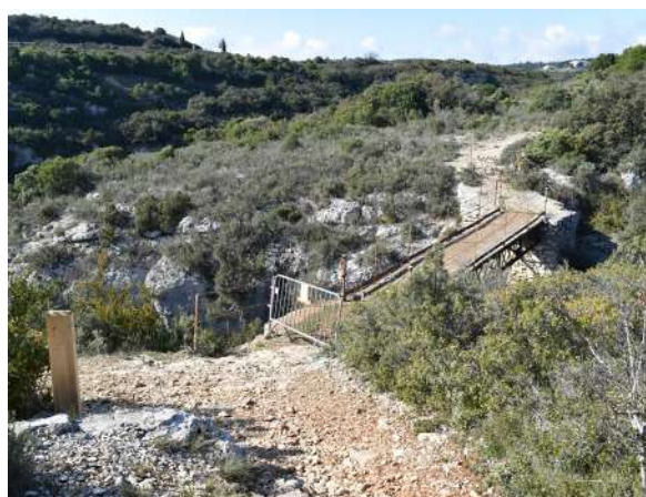
2 > La traversée du canyon de Coupiat menace de s'effondrer
