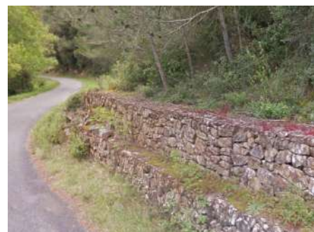
Le mur de gabions : – Gabion de maille double torsion (plus souple que la maille rigide, pierres calcaires rangées dans le type assisé) – À réserver pour les soutènements peu visibles depuis les routes et chemins
